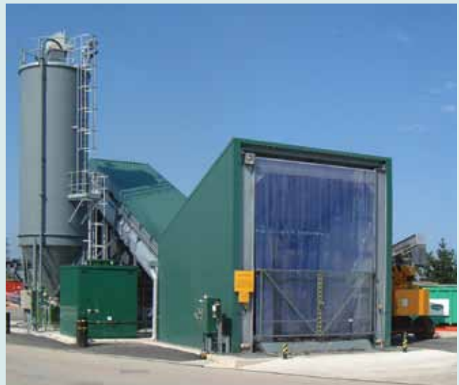
Unidades de recepción de materiales a granel
