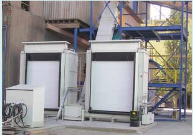
Estaciones modulares para descarga de contenedores
