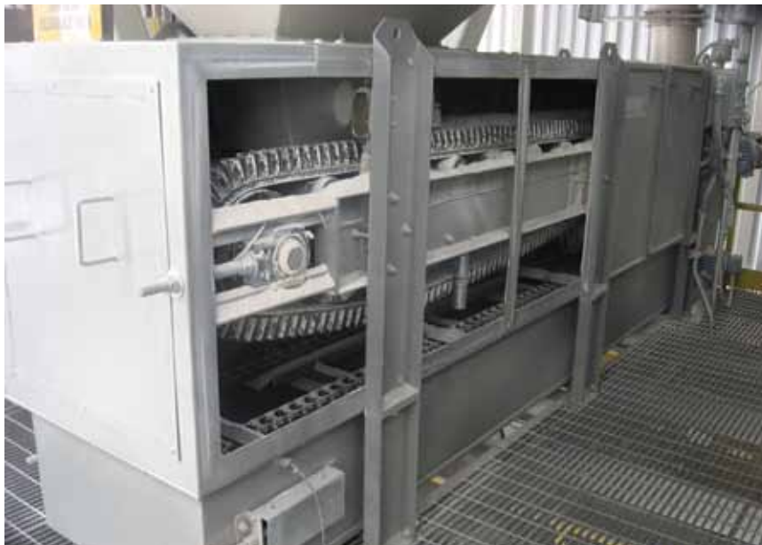
Banda Dosificadora DMO operando en una planta de fabricación de cemento.
